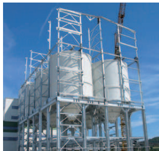
Anlage für Sandfrachtung und Transport, Provodin, Tschechische Republik Konstruktionsbüro: CAB minerals s.r.o., Brno, Tschechische Republik
